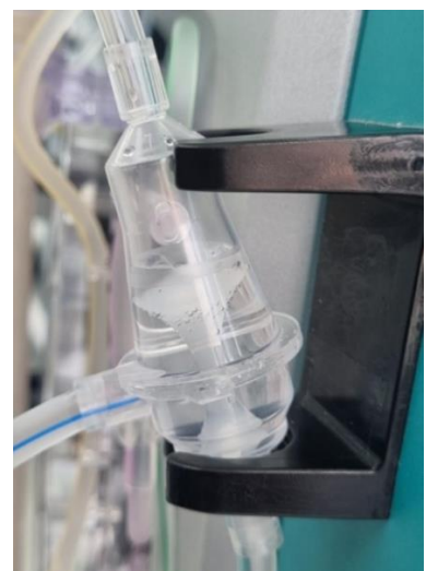
Fig 3: Cámara de desaireación desprendida del soporte
